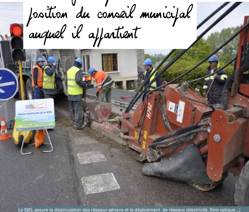
Le SIEL assure la dissimulation des réseaux aériens et le déploiement de réseaux (électricité, fibre optique...)
