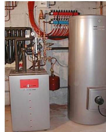
Pompe à chaleur avec production d'eau chaude sanitaire
