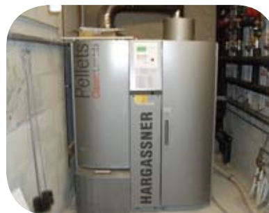
La Chaudière aux granulés de bois ▲
