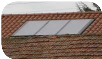
Le chauffe-eau solaire ▲
