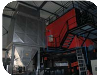
Chaudière automatique au bois ▲
